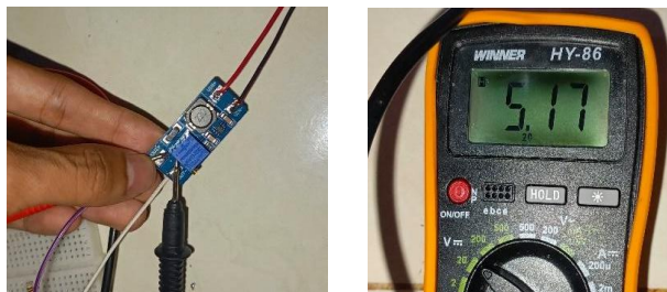
Gambar 8. Pengukuran Tegangan Output dari Step-up MT3608 Sumber : Penulis, 2026
